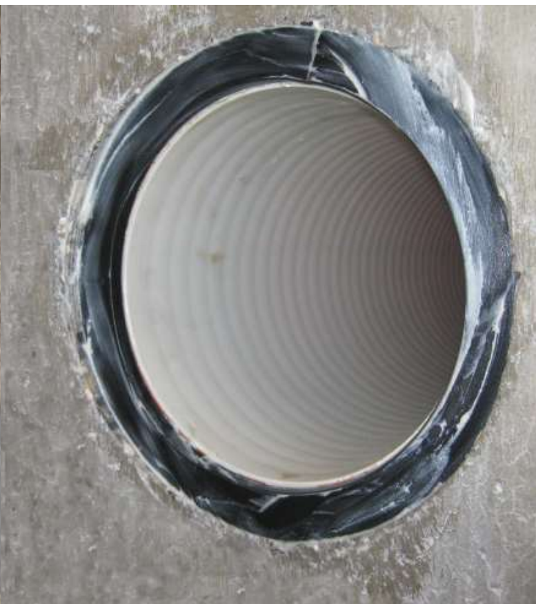
Ingen indragende dele i rør eller brønd.
